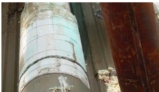
Figura 5. Calorifugado en tubería de vapor
