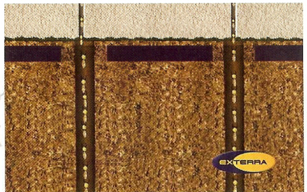
Termitas aprovechándose de huecos en una barrera
